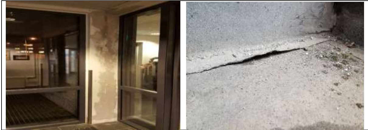
Mynd. Töluverður leki hefur skilað sér inn í anddyri. Yfirfara þarf þakdúk og mynda innsteypta lögn.
