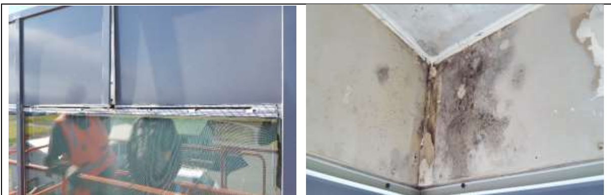
Mynd. Í vinnuherbergjum kennara (búr) voru þéttiborðar rifnir. Þegar loftaplötur voru teknar niður kom í ljós töluverð mygla í veggjum.
