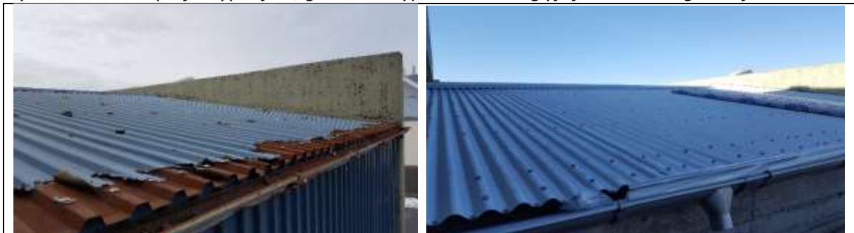
Mynd. Þakjárn var mikið ryðgað sem og rennur og niðurföll. Trapisujárni skipt út fyrir bárujárn.
