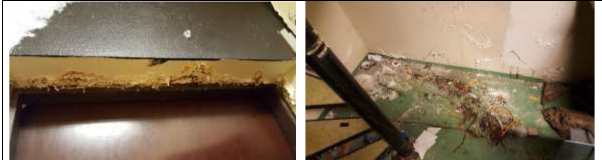
Mynd. Töluverðar rakaskemmdir í veggjum við svið. Í kjallara undir sviði er raki í veggjum og óprifnaður.
