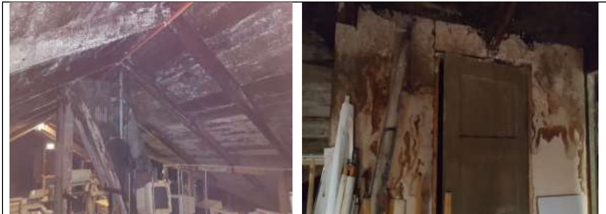
Mynd. Í risi hefur lekið töluvert inn um þak.
