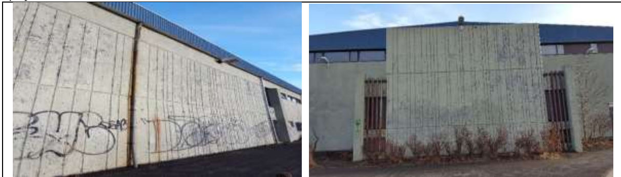
Mynd. Endurmála þarf steypa fleti, gera við steypuskemmdir og yfirfara rennur og niðurföll.
