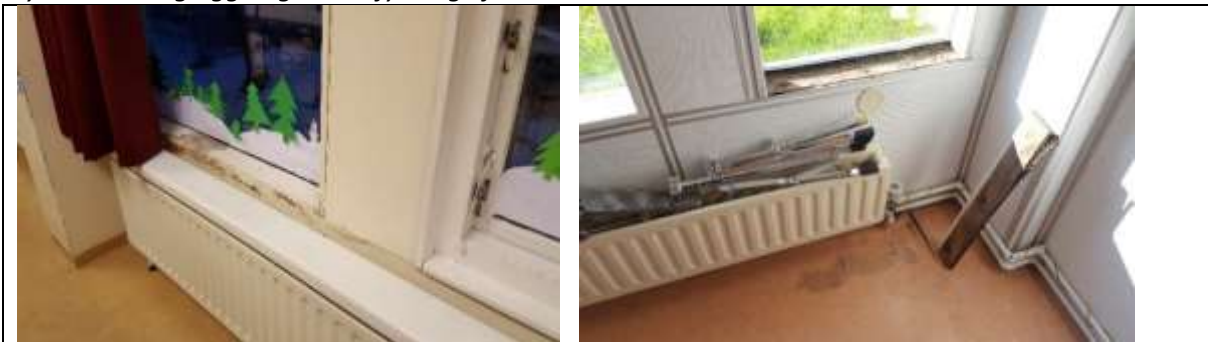
Mynd. Skemmdir í kennslustofum vegna leka.
