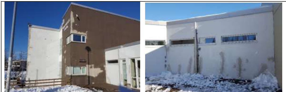
Mynd. Múrklæðningu þarf að yfirfara og endurmála.
