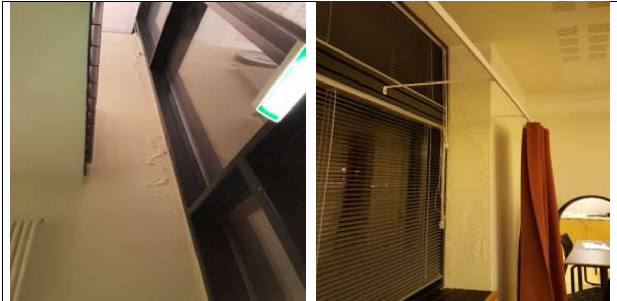
Mynd. Rakaskemmdir má sjá víðsvegar um bygginguna.
