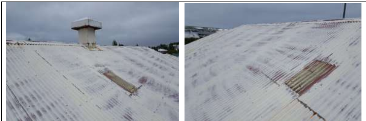
Mynd. Nauðsynlegt er að gera úttekt á þakinu öllu.
