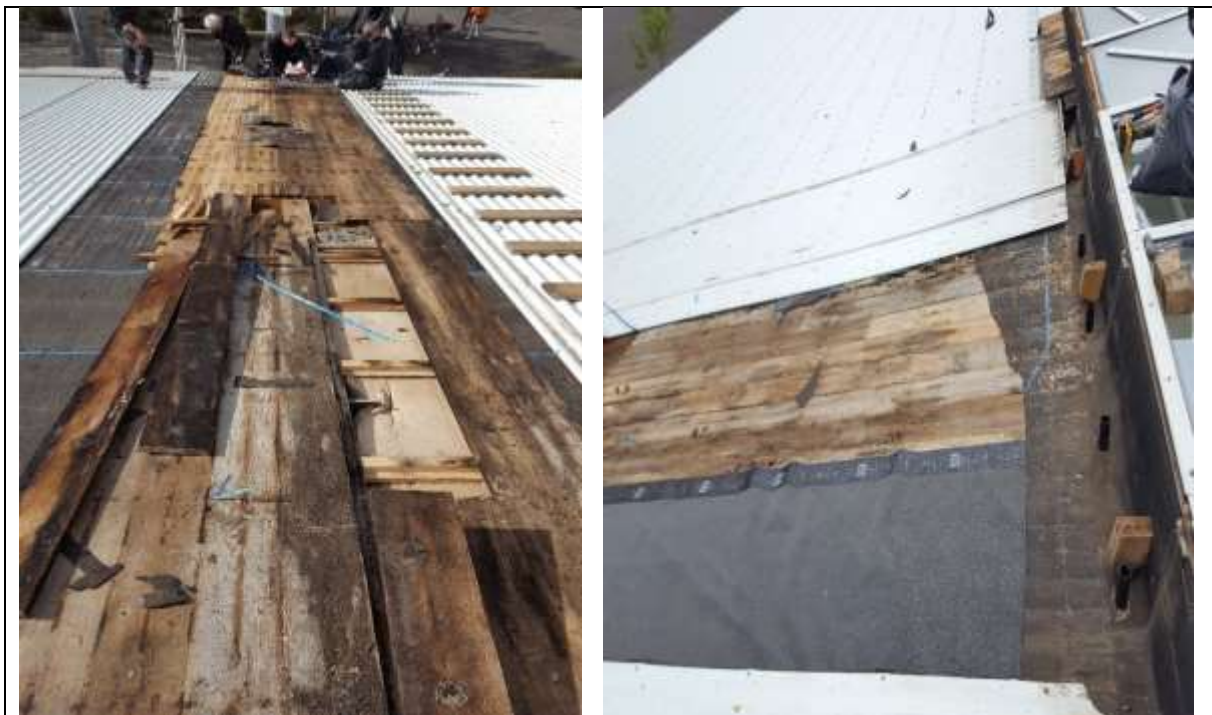
Mynd. Mikill raki og fúi í timbri við stofu 103. Engin kíttun í kring um loftunarrör og greið leið fyrir vatn inn.
