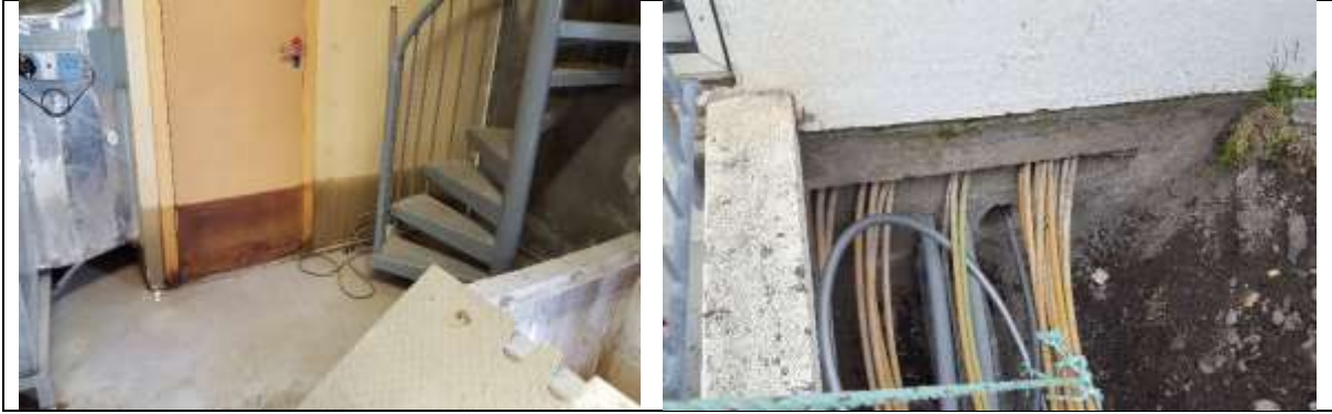
Mynd. Hér má sjá hversu mikið vatn skilaði sér inn í lagnakjallarann. Lagnir við inntakið voru lagaðar.
