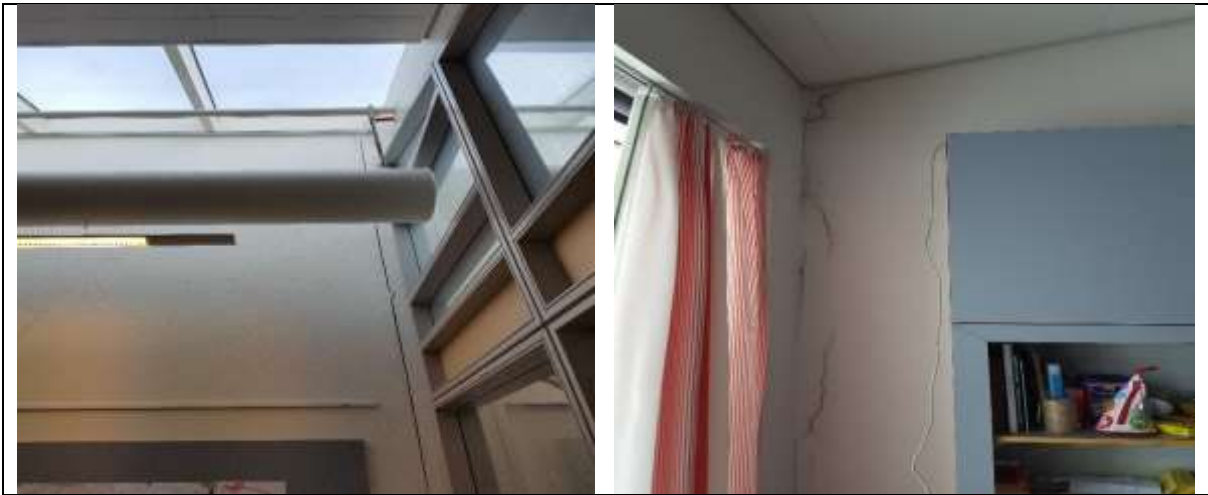
Mynd. Í vesturhluta byggingarinnar er töluvert um sprungur í veggjum.
