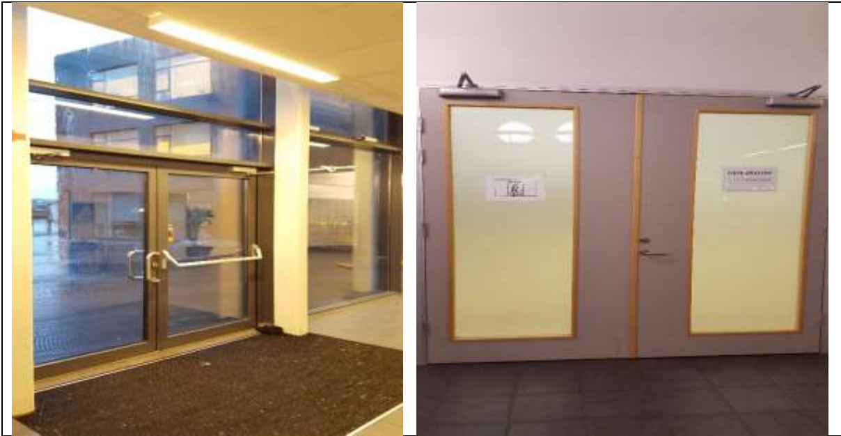
Mynd. Hurð út í port milli C og E álmu er hættuleg á vindasömum dögum, besta lausnin er að byggja vindfang. Neyðarhurðir á íþróttasal eru ónýtar og nauðsynlegt að fá vandaðri og öflugari hurðir í starfsemi sem þessa.
