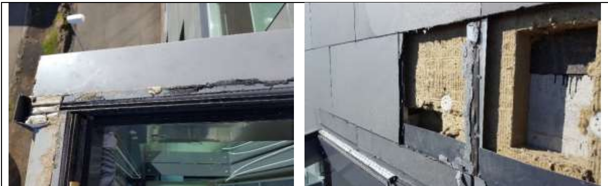
Mynd. Í vinnuherbergjum kennara (búr) voru þéttingar ekki í lagi. Einnig var frágangur álkerfis við steypta veggji ekki heldur í lagi og ekki unnið samkvæmt teikningum.
