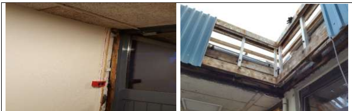
Mynd. Í tengibyggingu milli D og E álmu var mikill leki sem skilaði sér inn í bygginguna.
