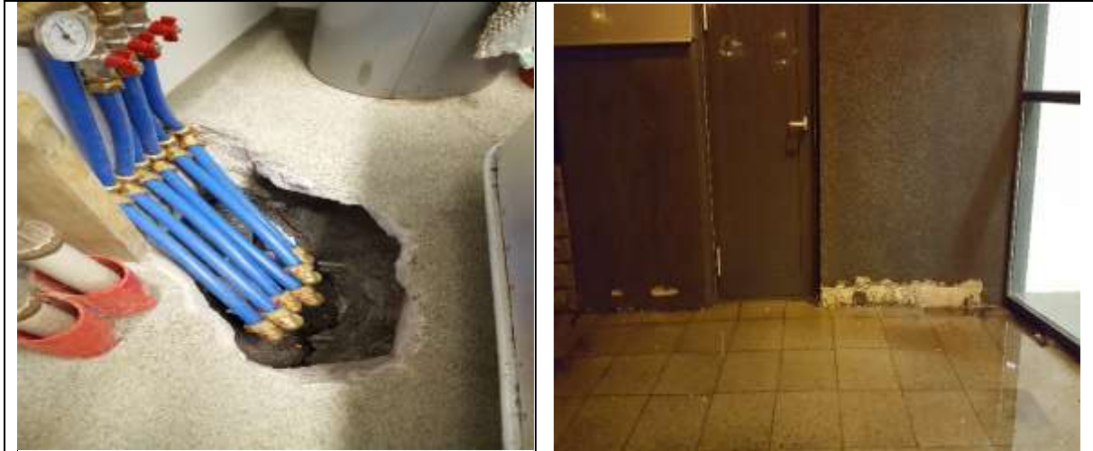
Mynd. Lekir með snjóbræðslulögnum var lagaður. Múrklæðning er hrúin af veggjum að hluta.
