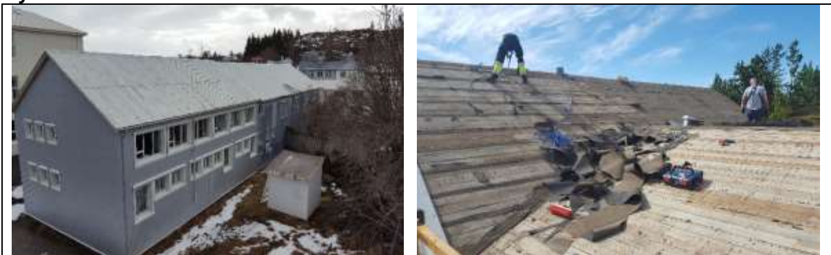
Mynd. Þakjárn orðið töluvert ryðgað. Borðin litu vel út undir pappanum og enginn fúí sjáanlegur utanfrá.
